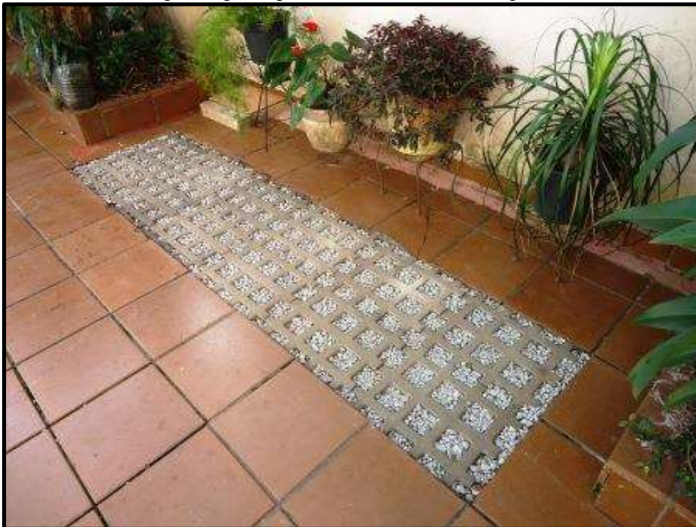
Foto de um dispositivo doméstico de acumulação/infiltração já instalado em plena operação
