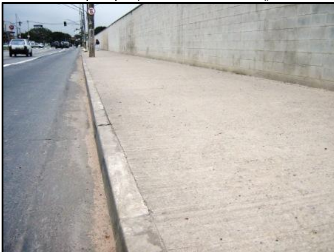
Cena real com valeta e calçada totalmente impermeáveis
