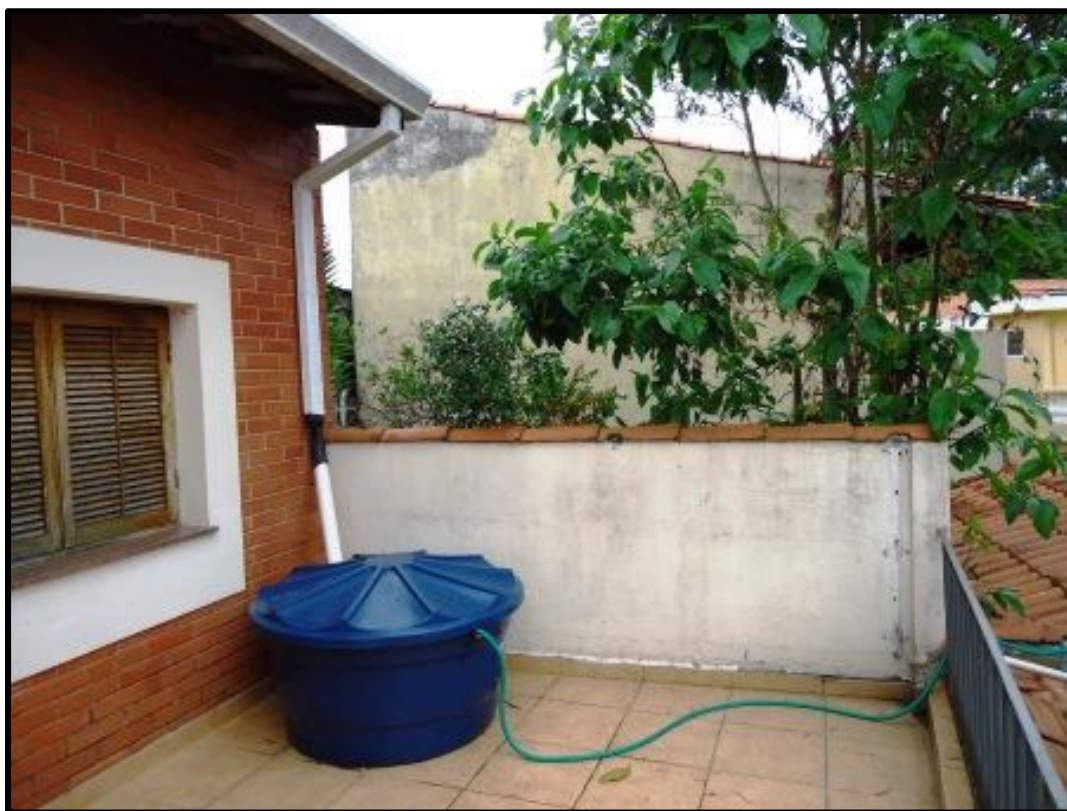
Uma outra instalação para acumulação e uso de águas de chuva incidentes sobre telhados
