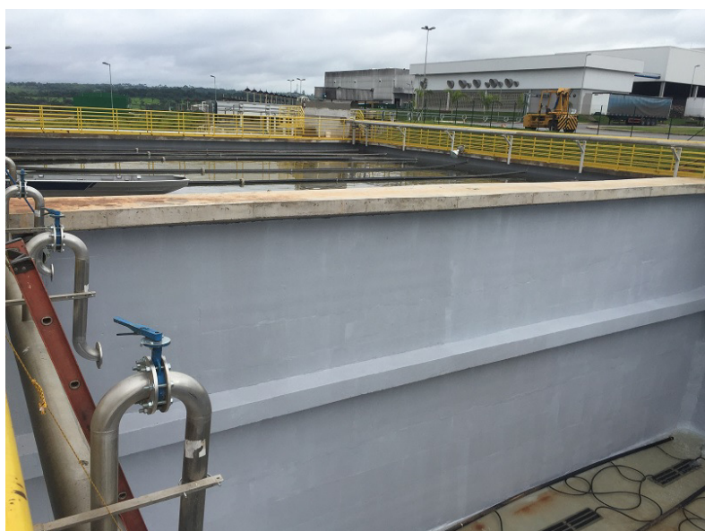
Figura 13- Tanque de aeração recuperado com cintas protendidas
