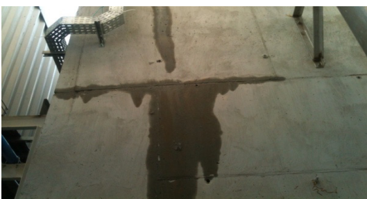
Figura 4- Infiltração advinda da junta fria não tratada.
