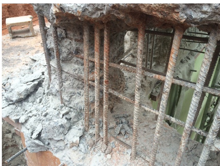
Figura 8 - Ausência de armadura horizontal na mísula
