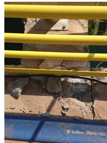
Figura 3-Trincas na ligação das paredes
