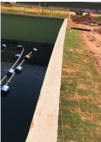
Figura 1-Parede externa deformada devido ao empuxo de terra
